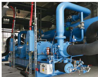
Foto: Zuidas: KPC, koudeproductiecentrale heeft de grootte van enkele huizen. Bij de afnemer in het gebouw wordt er juist ruimte bespaard.
