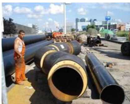
Foto: primaire en secundaire netwerk: buizen met diameter van > 60 centimeter. .
